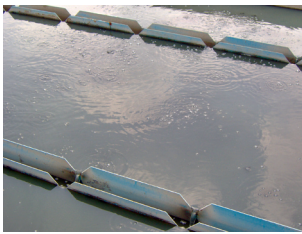
Filtros anaerobios y cloración. PTAR Los Volcanes, en Chalco, Estado de México.
