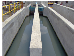
Campanas y canaletas de rebose de un reactor anaerobio UASB
