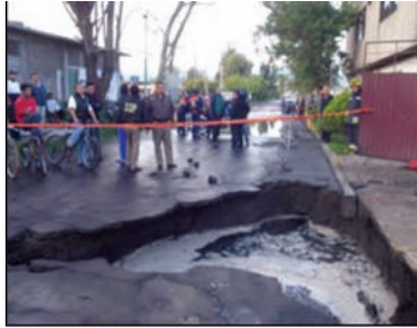
Hundimiento de planta baja de una casa-habitación en Chalco, Dr. Agustín Breña, UAM-I
