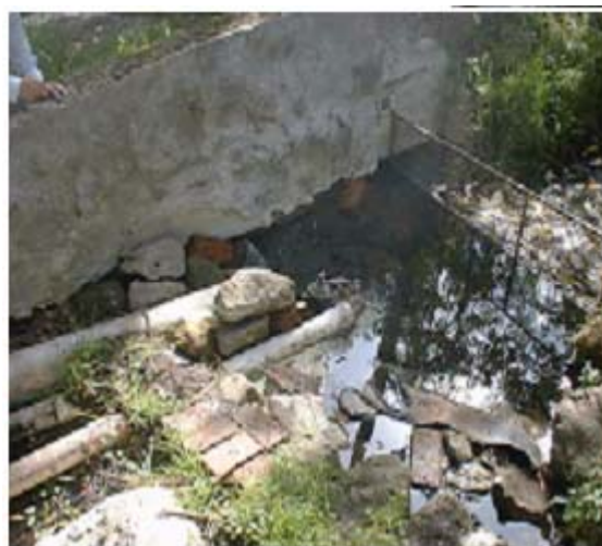
Foto 1. Condiciones sanitarias de un pozo ubicado en Santa Rita Tlahuapan
