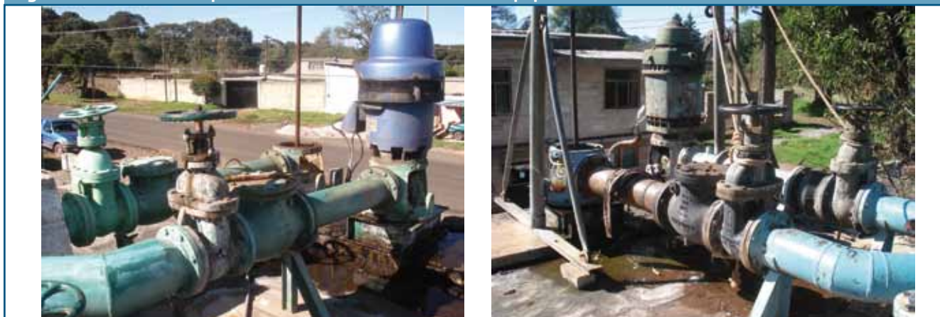
Figura 4.11 Problemas típicos de falta de mantenimiento en equipos de bombeo
