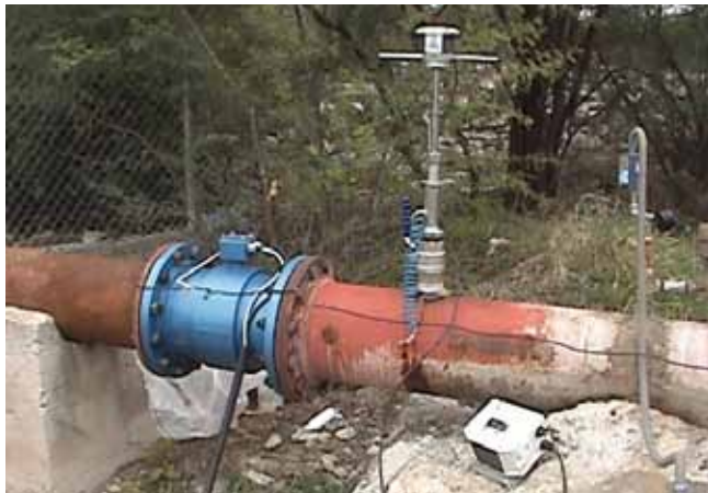
Figura 1.4 Medición de error de exactitud en macromedidor instalado (color azul), con medidor portátil electromagnético de inserción
