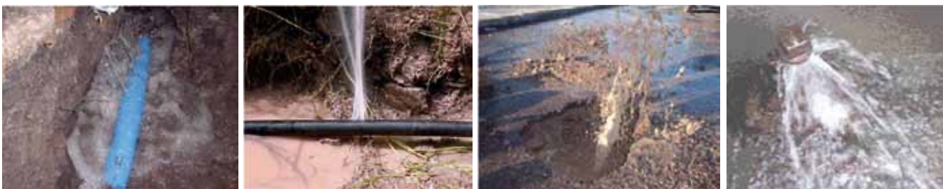
Figura 5.4 Fugas típicas de agua en redes de agua
