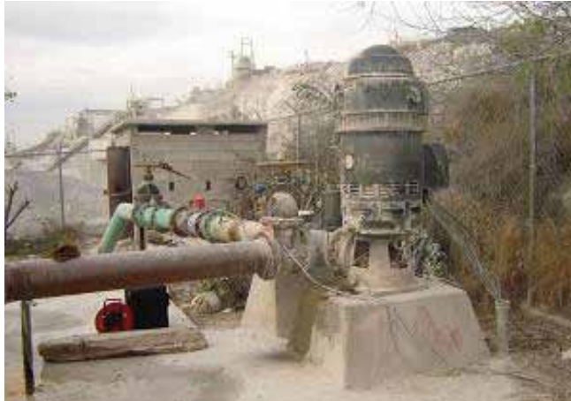
Figura 5.1 Equipo de bombeo con eficiencia baja
