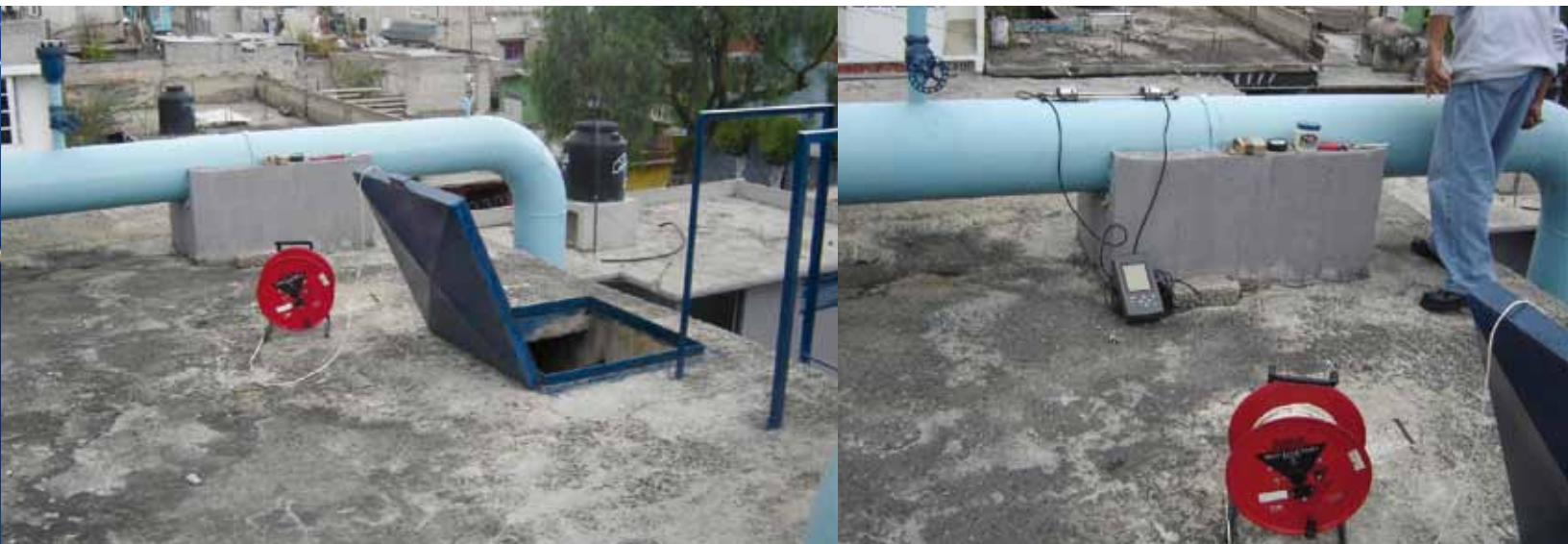
Figura 1.22 Medición del nivel dinámico en cárcamos de bombeo
