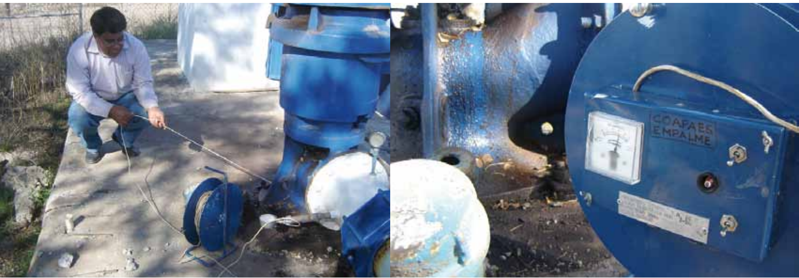
Figura 1.21 Medición del nivel dinámico de succión en cárcamos de rebombeo
