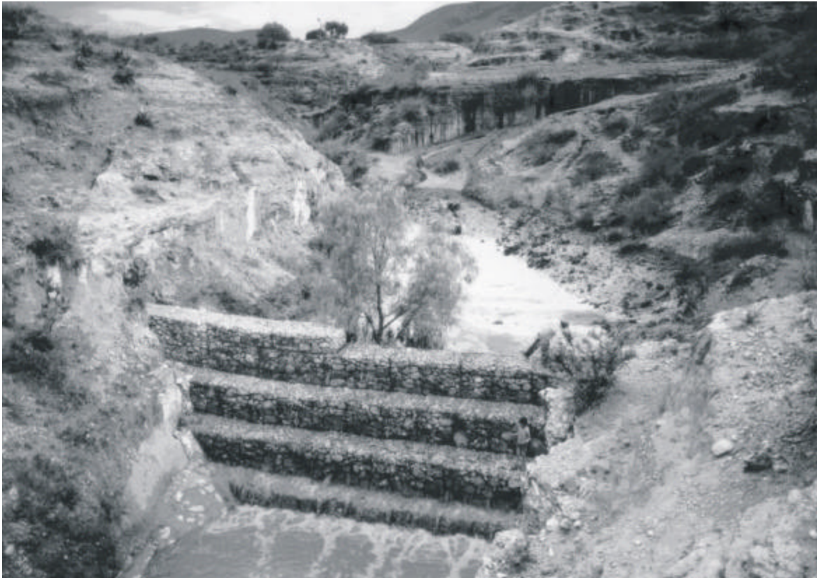
(91) Represa filtrante de gaviones, Santa María La Alta.
