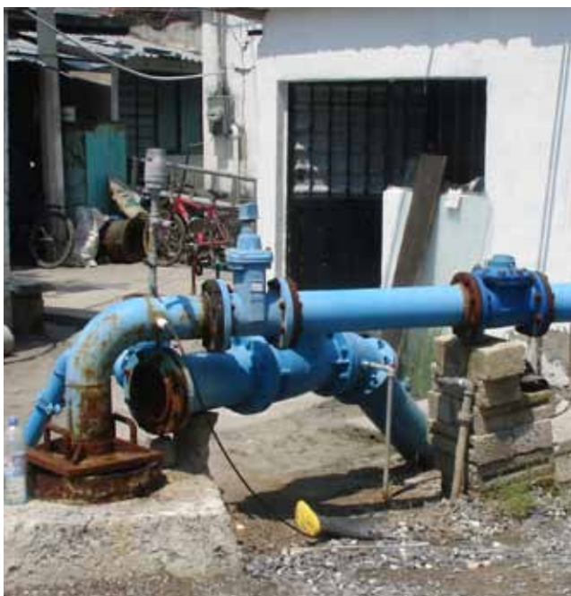
▲ Condiciones de operación pozo del organismo operador del Municipio de Zacatepec, agosto 2008
