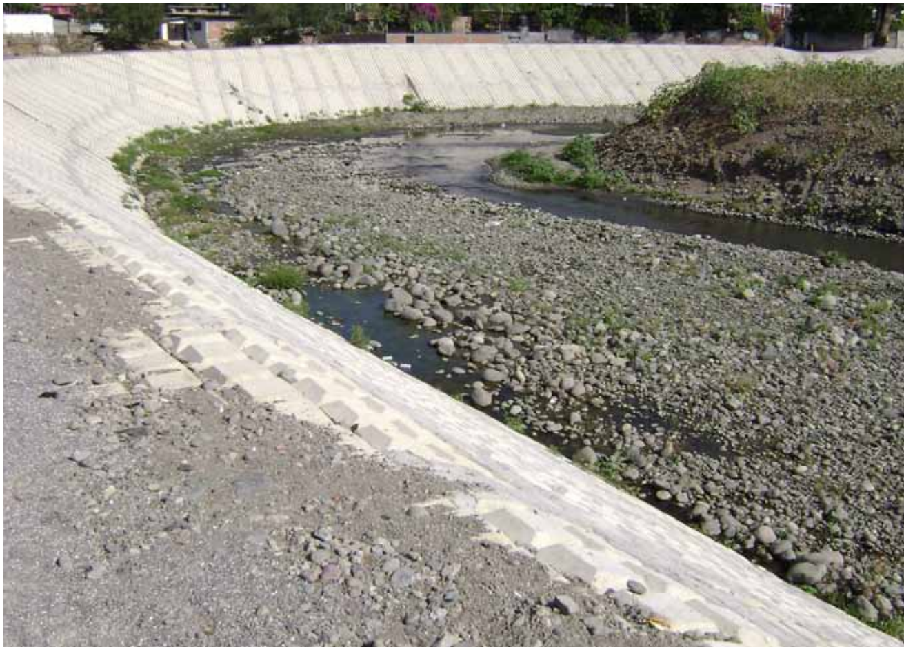
▲ Encauzamiento de río Apatlaco con tecnología de concreto flexible, Acatlpa, Municio de Temixco, julio 2010
