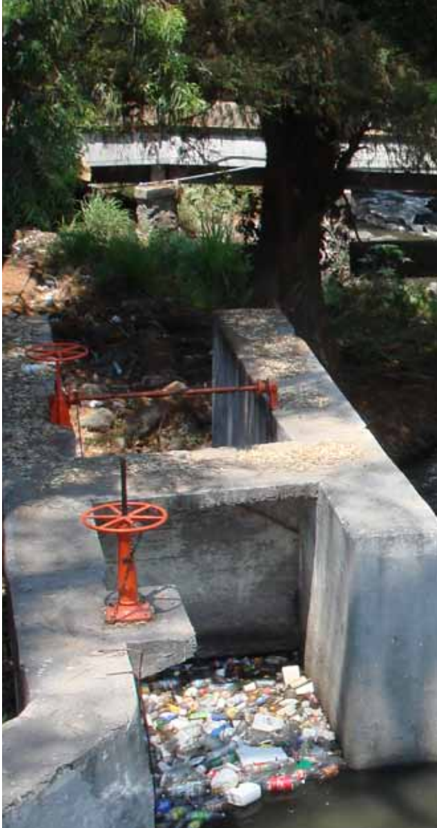
▲ Contaminación de ríos y acumulación de residuos sólidos (PET) en obras de toma, río Apatlaco, agosto 2008
