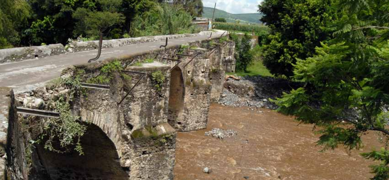
▲ Antigo puente de piedra, sobre río Cautla, Coahuixtla, Municipio de Cautla, julio 2010
