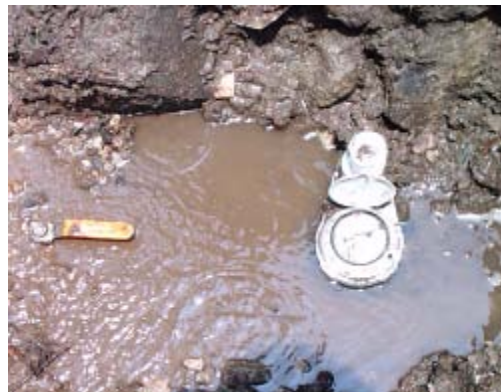
Figura 9. Medidor expuesto a sumersión y humedad.
