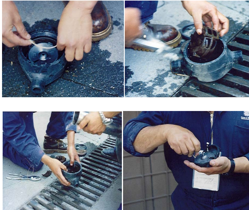
Figura 30. Desarmado de la cámara de un medidor.
