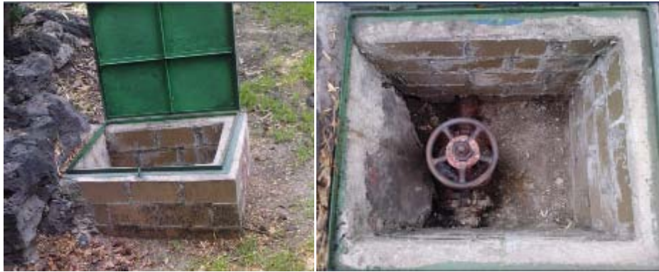
Figura 7. Toma de agua potable con poca disponibilidad de espacio, vulnerabilidad de robo y una gran existencia de árboles.
