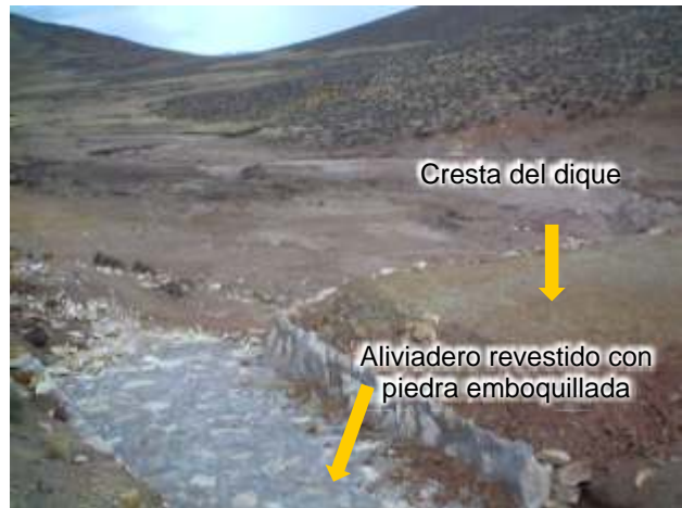
Aliviadero microrrepresa Ccacasuico, Chalhuanca, Caylloma.
