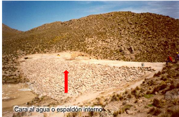
Talud interno o "cara al agua" de la microrrepresa Mollepunko", San Juan de Tarucani, Arequipa.
