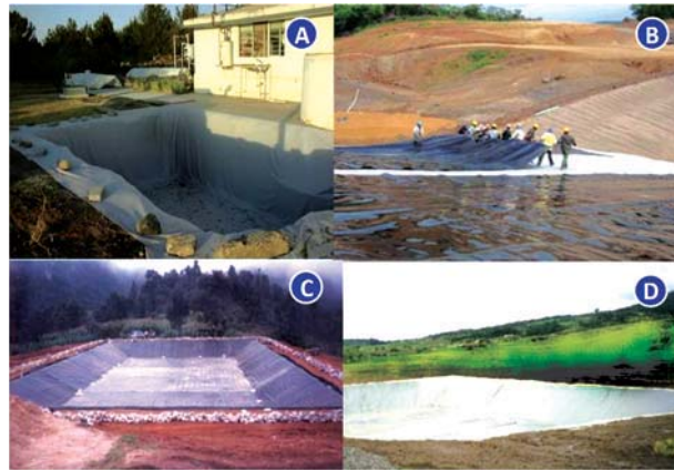
Figura 2.15 Cisternas revestidas con geomembrana de PVC
