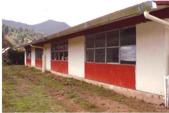
Figura 2.27 Canaletas para la colección de agua de lluvia en la escuela primaria de los Reyes, Michoacán
