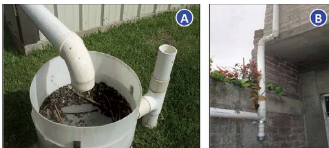
Figura 2.20 a) Trampa de basura, b) válvula para drenaje
