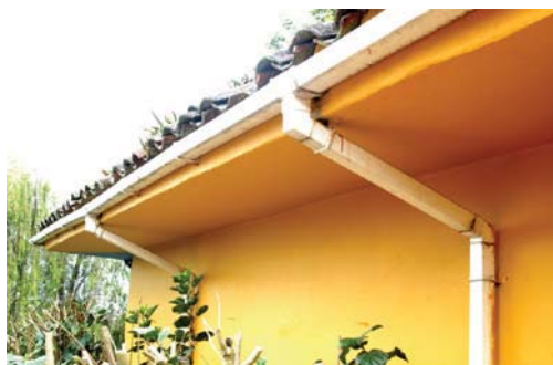
Figura 2.30 Bajada de agua de lluvia de los techos
