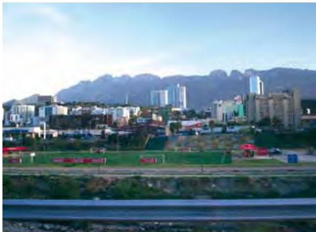
Foto 15. Construcción de canchas deportivas en la zona inundable del río Santa Catarina en Monterrey, N.L. Nótese al frente la margen derecha del cauce de estiaje.
