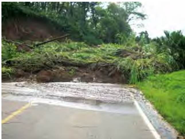
Foto7. Deslizamiento en carreteras.
