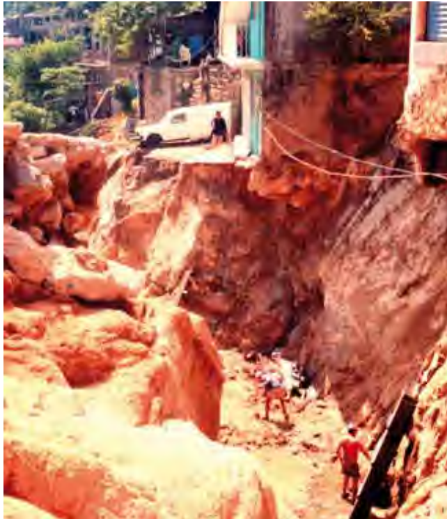
Foto 5. Erosión de cerca de 6 m de profundidad producida por corrientes sobre calles de gran pendiente causadas por las lluvias del huracán Pauline (1997) en Acapulco. Fotografía por M. Rosengaus.
