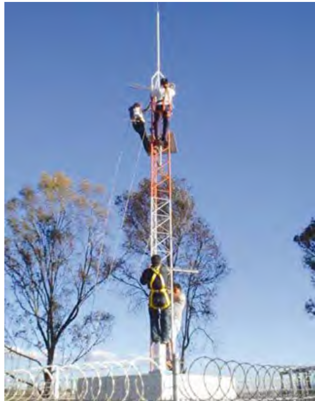
Foto 4. Instalación de la torre atirantada, panel solar y antena de comunicación de un PCD.
