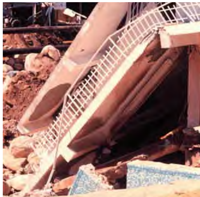
Foto 6. Consecuencia de ubicar la cimentación de algunas columnas de la construcción dentro del cauce de un arroyo en Acapulco durante las lluvias por Pauline (1997). Fotografía por M. Rosengaus.
