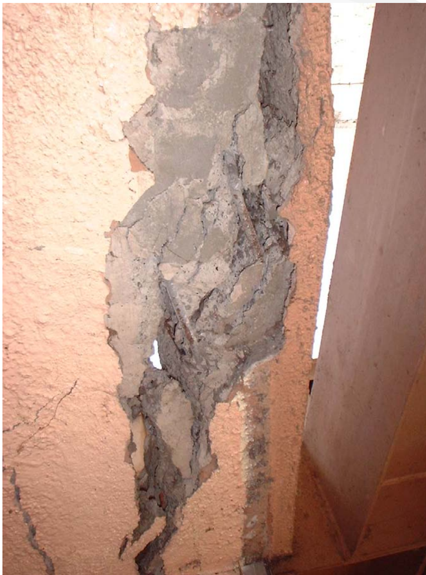
FISURAS EN MUROS
