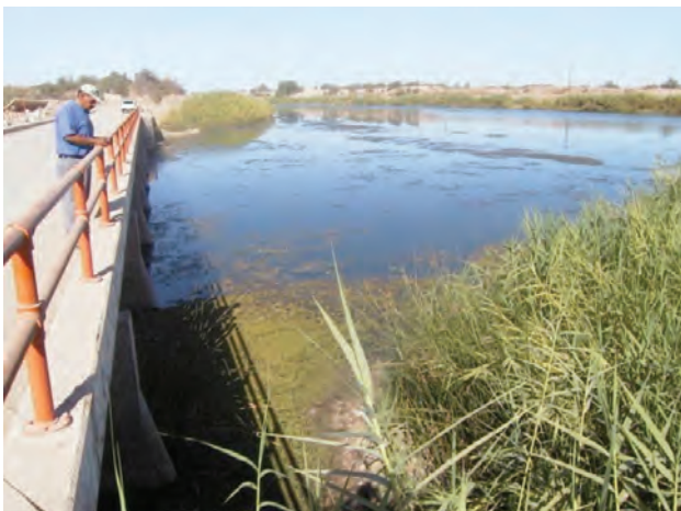
Compuertas de la presa Morelos.
