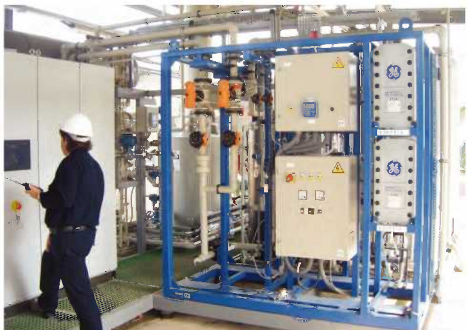
Figura 3. Vista parcial de la unidad de electrodesionización.
