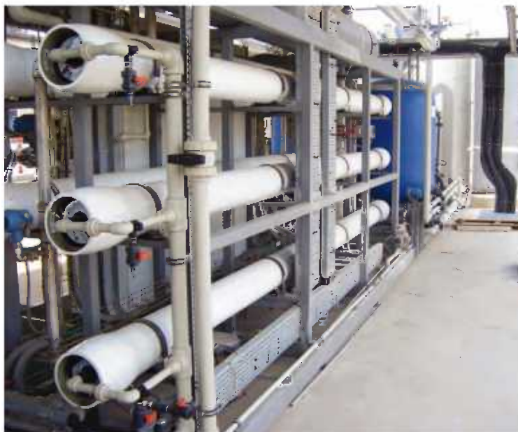
Figura 2. Vista parcial del sistema de ósmosis inversa.
