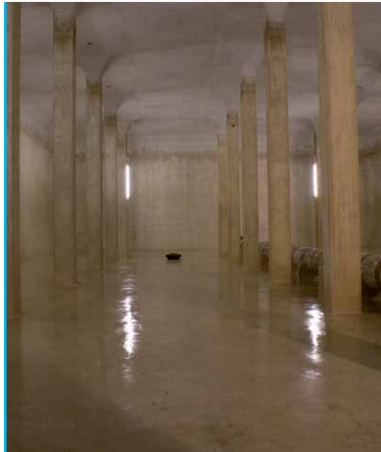
Depósito de agua potable subterráneo
