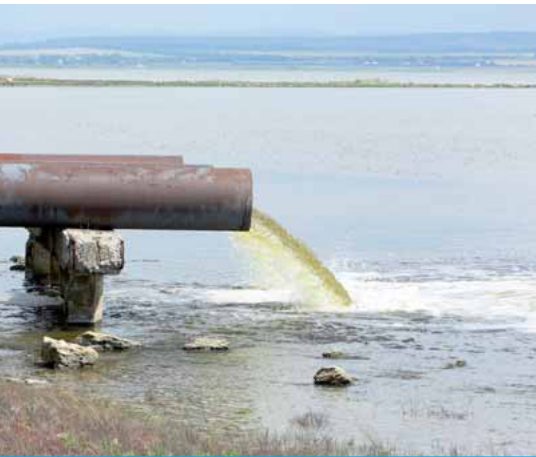
Vertido de aguas residuales
