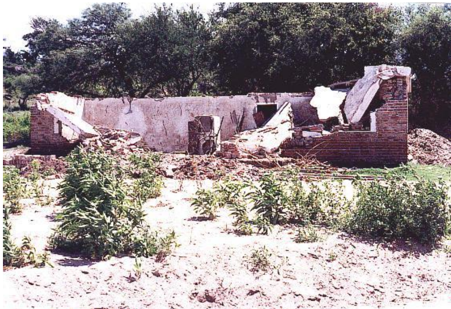
Foto 9.2. Estado típico de las construcciones luego evento del 06/01/92 en S. C. Minas.
