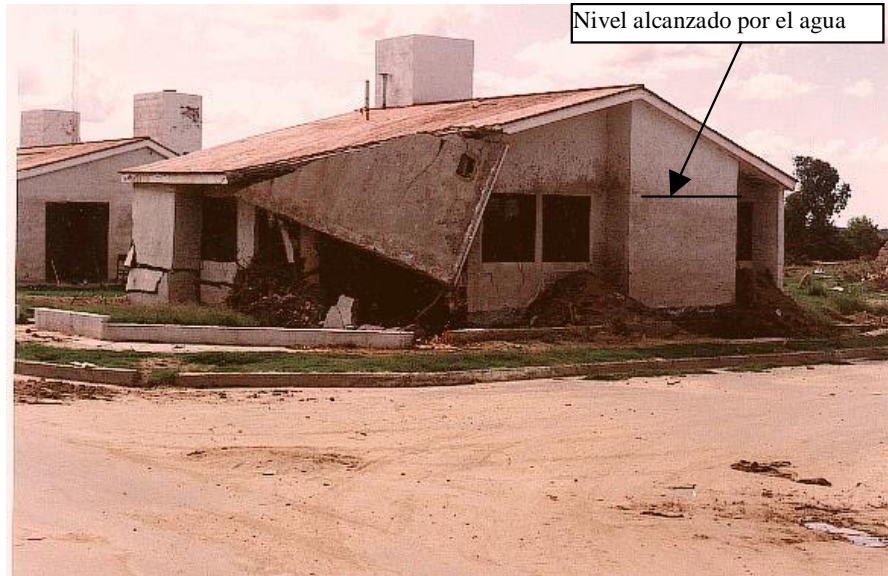
Foto 9.3. Daños sobre viviendas en el barrio IPV. Evento del 06/01/92 en S. C. Minas.
