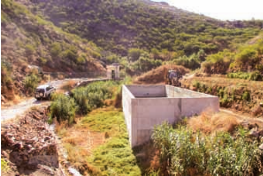
Foto 5.24. Planta compacta por Fangos Activados. EDAR La Coruña (Gran Canaria - Las Palmas).
