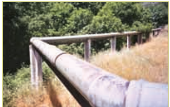
Foto 3.2. Colector de entrada. EDAR de Almonaster la Real (Huelva)
