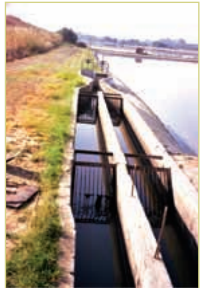
Foto 3.3. Canal de desbaste. EDAR de Almonte (Huelva)
