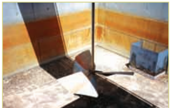
Foto 3.8. Detalle de tratamiento fisicoquímico (c mara de floculación-coagulación). EDAR de El Rompido (Huelva)
