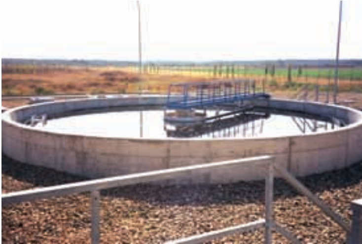
Foto 5.22. Decantador Secundario. EDAR de El Rocío (Huelva).
