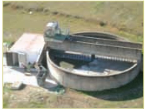
Foto 3.13. Espesador de lodos. EDAR de Manilva (Málaga)
