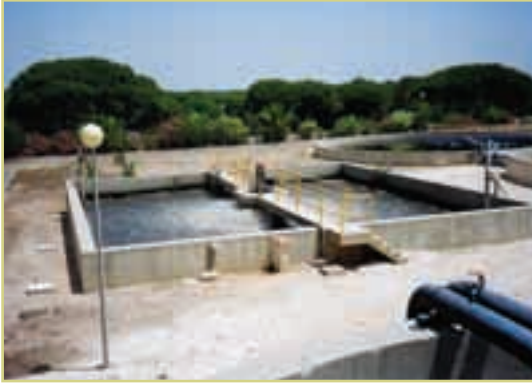
Foto 3.9. Detalle de Reactor Biológico. EDAR de El Rompido (Huelva)
