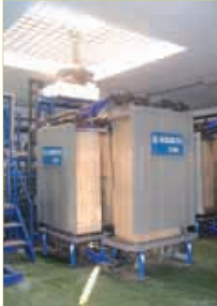
Foto 3.11. Detalle de Tratamiento Terciario. EDAR de Maspalomas (Gran Canaria-Las Palmas)
