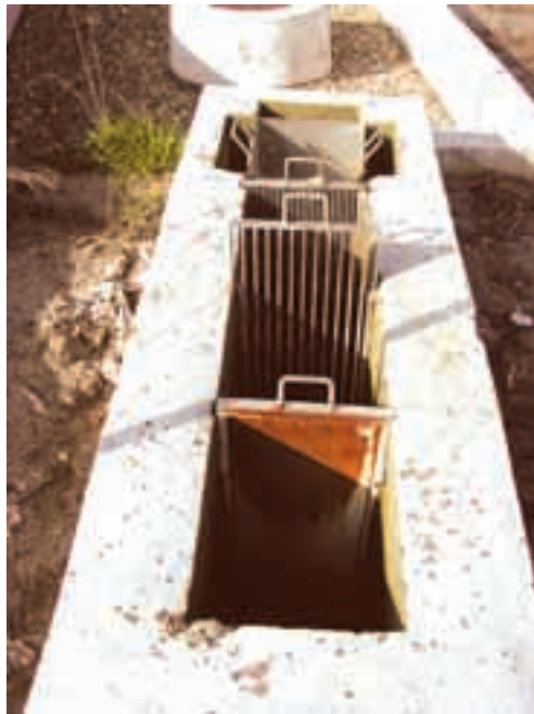
Foto 5.1. Rejas de desbaste. EDAR de las Tablas (Cádiz).
