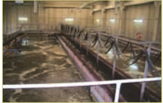
Foto 3.6. Detalle de desarenador-desengrasador aireado. EDAR de El Bobar (Almería)
