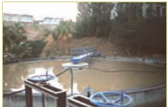
Foto 3.7. Detalle de Decantador Primario. EDAR de Arroyo de la Miel (Málaga)
