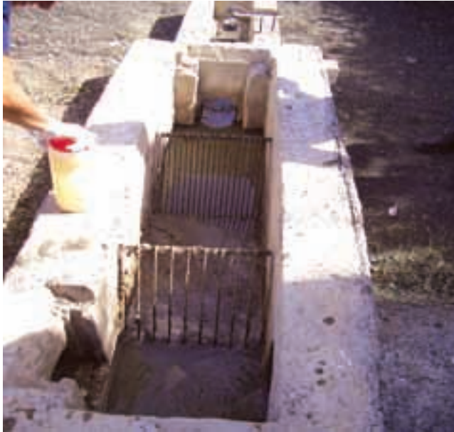
Foto 5.2. Rejas de desbaste. EDAR de Casa Aguilar (Gran Canaria - Las Palmas).
