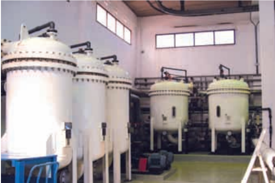
Foto 5.26 Filtros de Diatomeas. EDAR del Sureste de Gran Canaria (Las Palmas).
