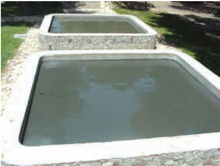
Foto 5.13. Lagunas Anaerobias. Centro de Transferencia Tecnológica (Tetuán).
