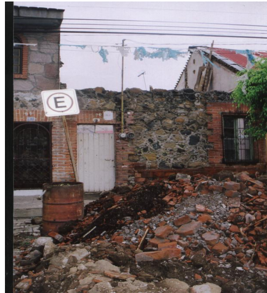
Fig. 5 Degradación del conjunto de viviendas. Fuente: idem .
