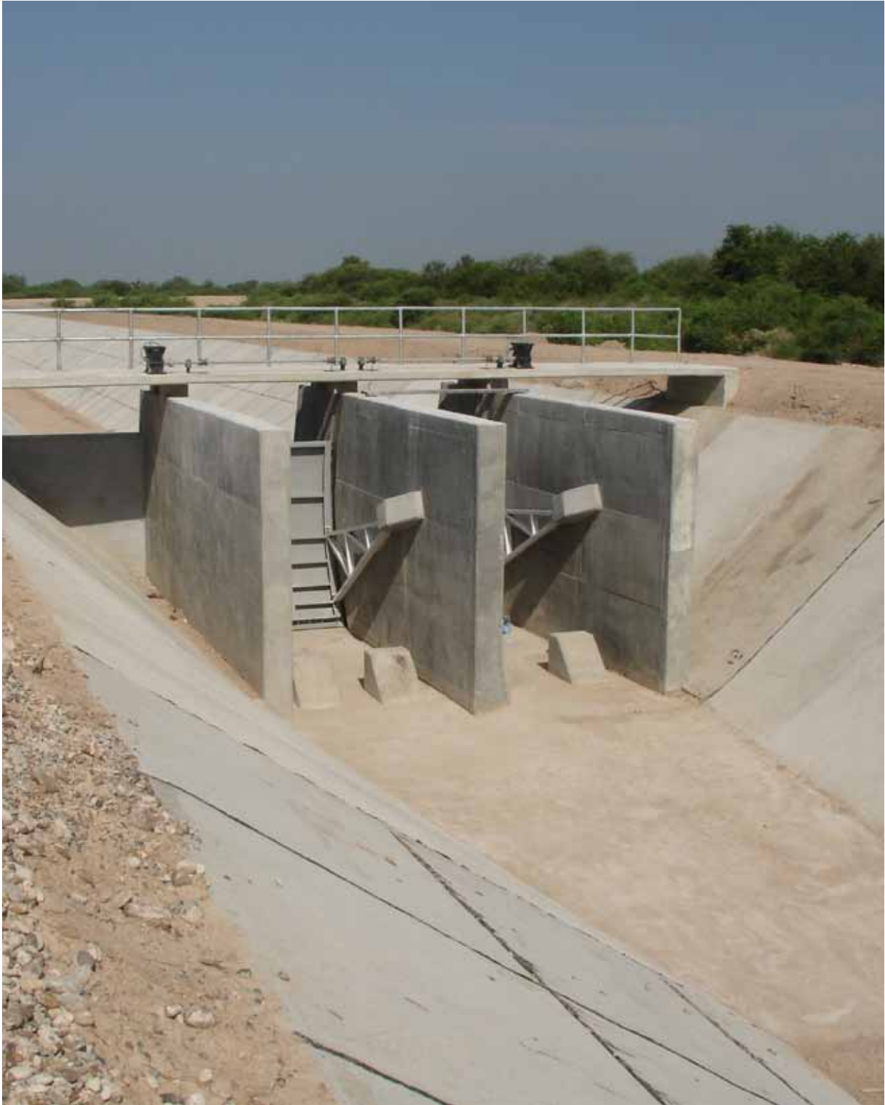
Vista parcial de la nueva infraestructura de riego del DR 004 Don Martín.
