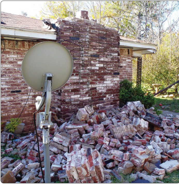
Daños producidos en una residencia por un terremoto de magnitud 5.7, que afectó a Praga, Oklahoma en 2011.
