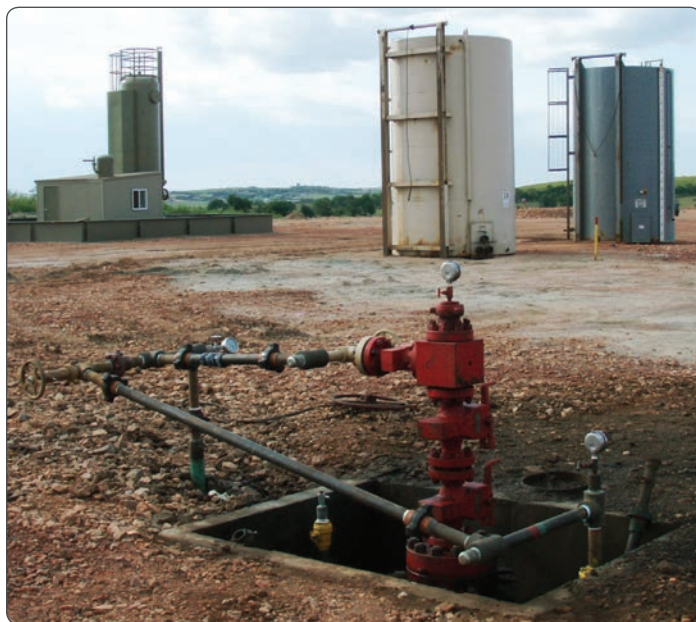
Cabezal de un pozo después de retirado los equipos de fracking del lugar de perforación.
