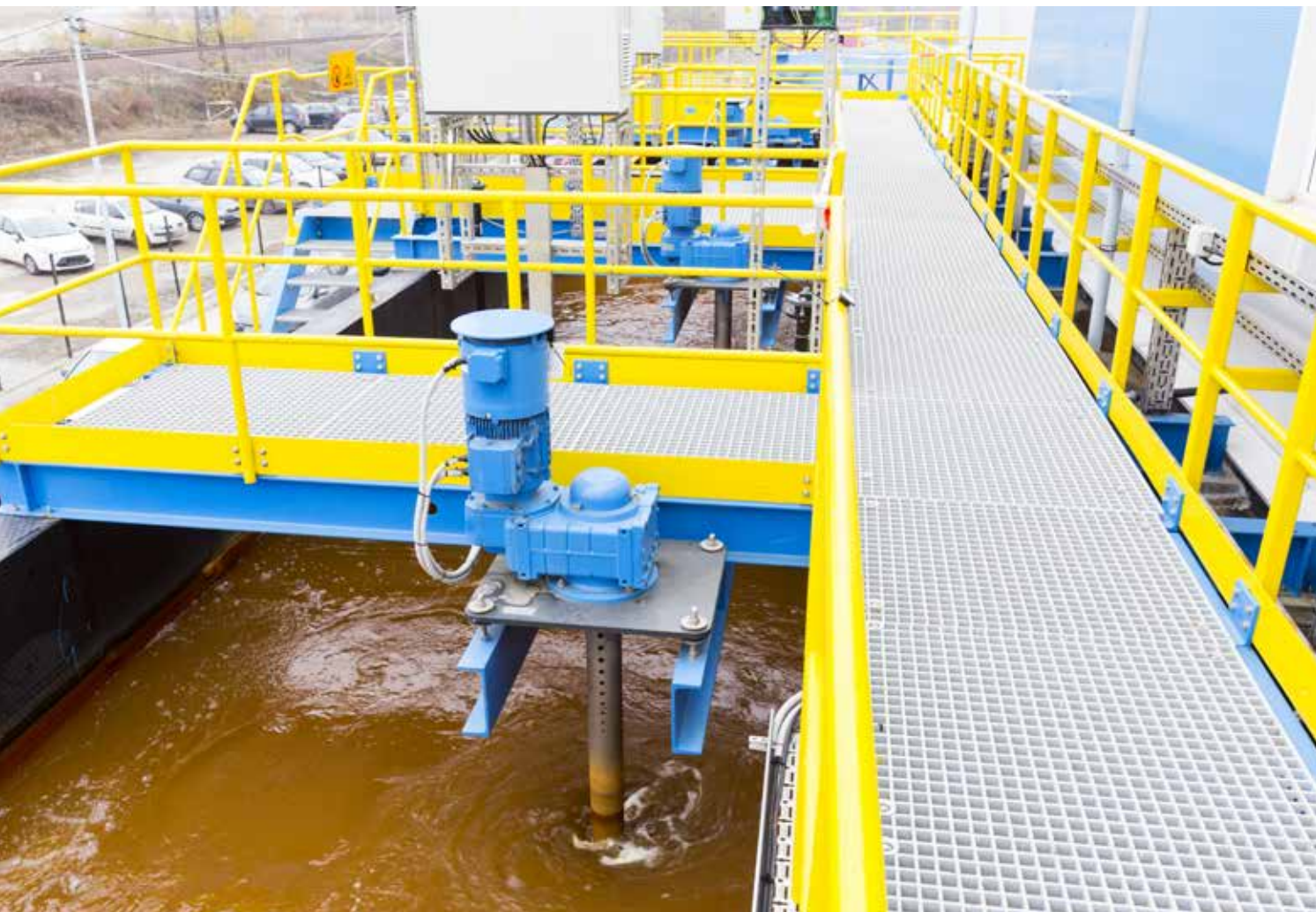
Planta depuradora de aguas pluviales Fotografía: © Cylonphoto/Shutterstock.com
