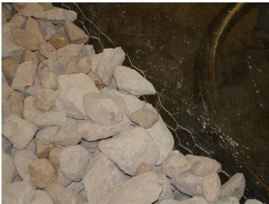
Foto 15. Detalle de la malla metálica instalada junto al cristal del canal.
