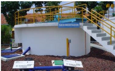
Operación de plantas de tratamiento de lodos activados 40 horas
