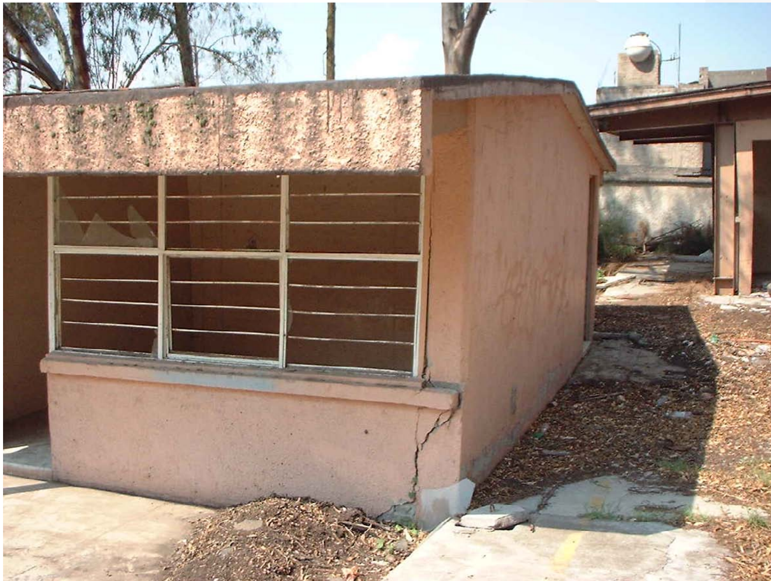
FISURAS EN MUROS
