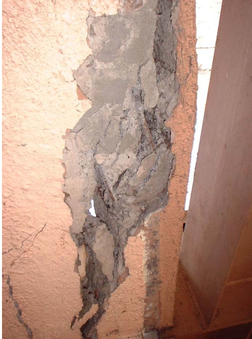
FISURAS EN MUROS
