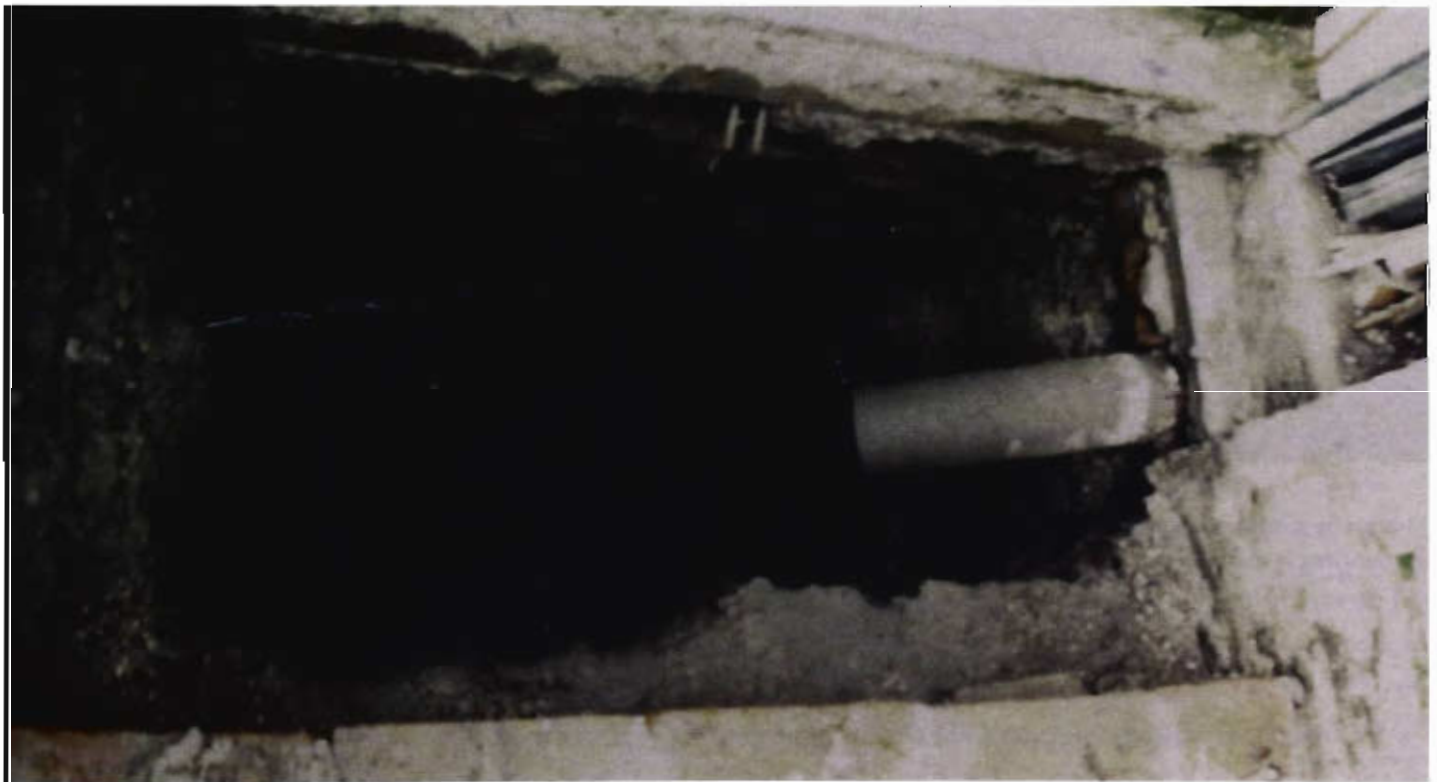
Pozo doméstico de reinyección de agua al acuífero, Revolución 1824, San Pedro de los Pinos. Después de almacenarla en depósitos, los excedentes del agua de lluvia son canalizados al subsuelo para contribuir a disminuir los hundimientos.
