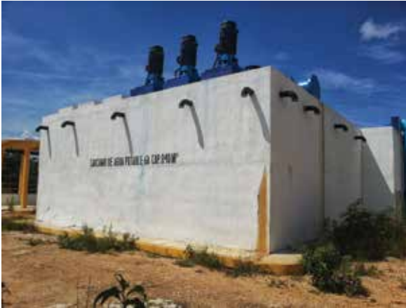
Ilustración 2.8 Tanque superficial de concreto
