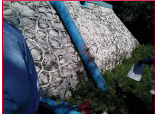
Ilustración 2.18 Medición de gasto en la llegada a tanque con equipo portátil (IMTA, 2013)
