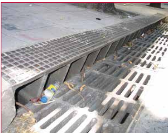
Ilustración 2.15 Boca de tormenta
