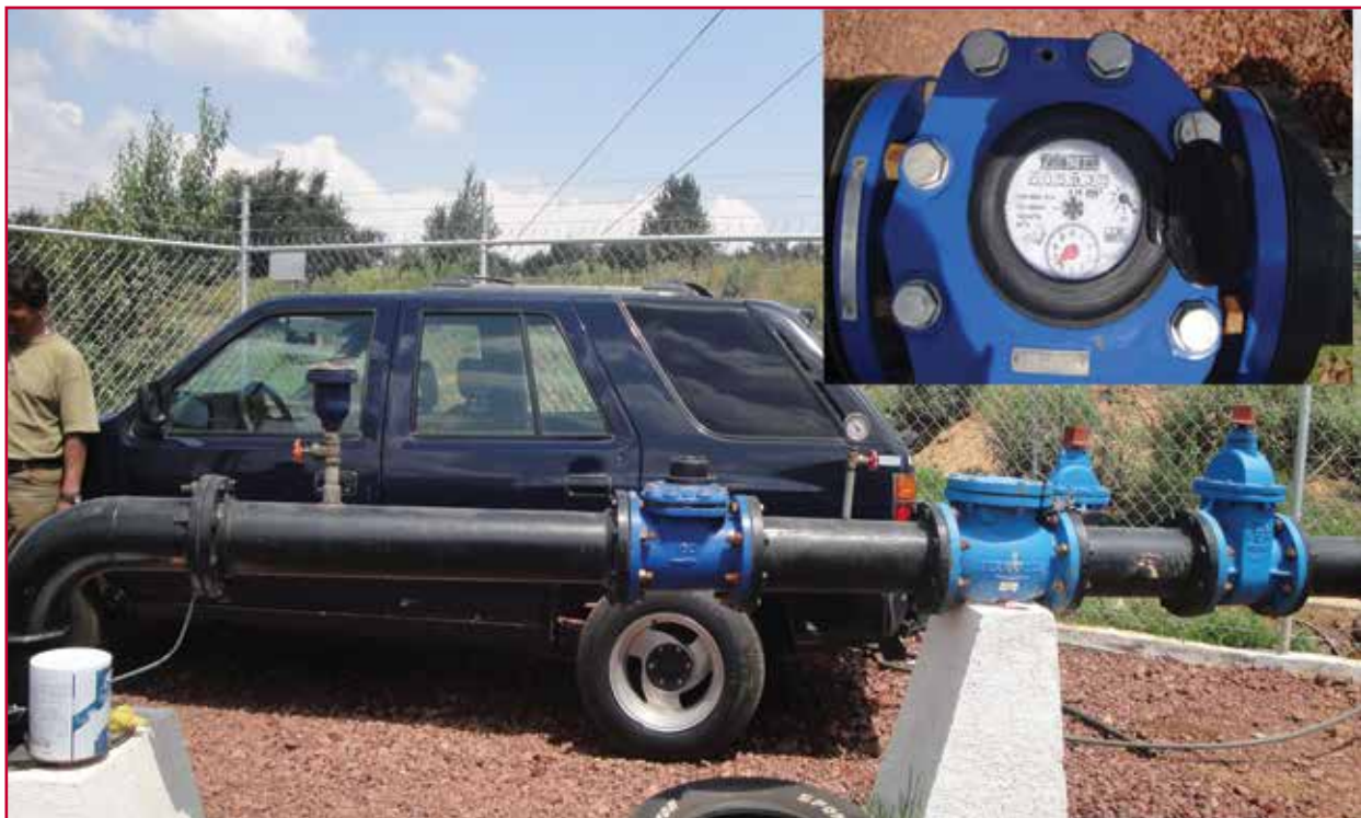
Ilustración 2.16 Macromedidor electromagnético instalado en el tren de descarga de un pozo
