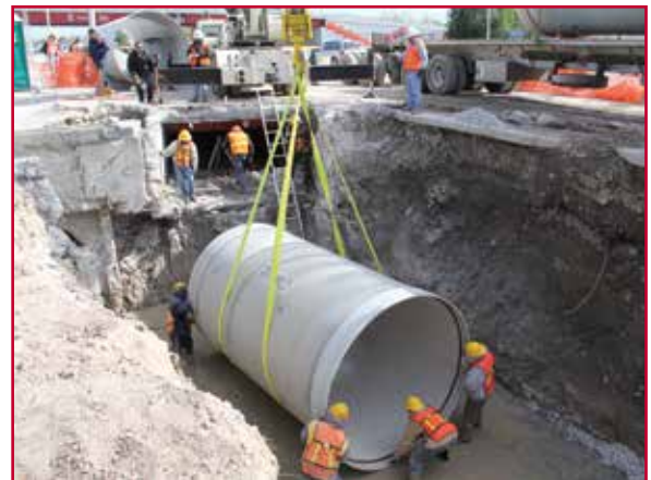
Ilustración 2.12 Tubería para drenaje pluvial
