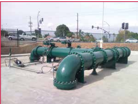
Ilustración 2.10 Estación de rebombeo (recuperado de www.akmce.com )
