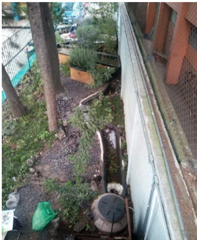
Figura 5. Humedal acuático y tanque de recepción.
