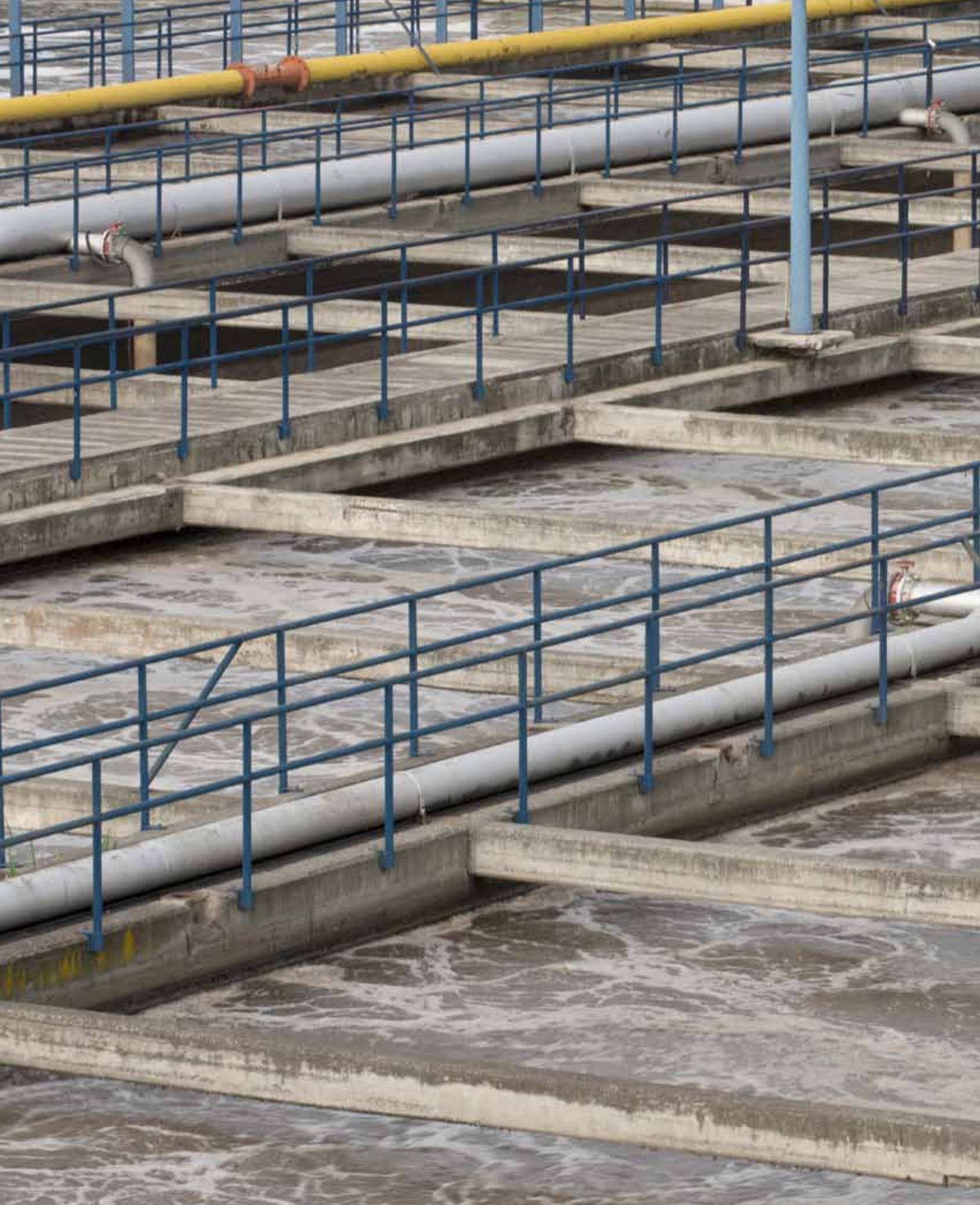
Sistema de aireación en la planta de tratamiento de aguas combinadas Cerro de la Estrella.
