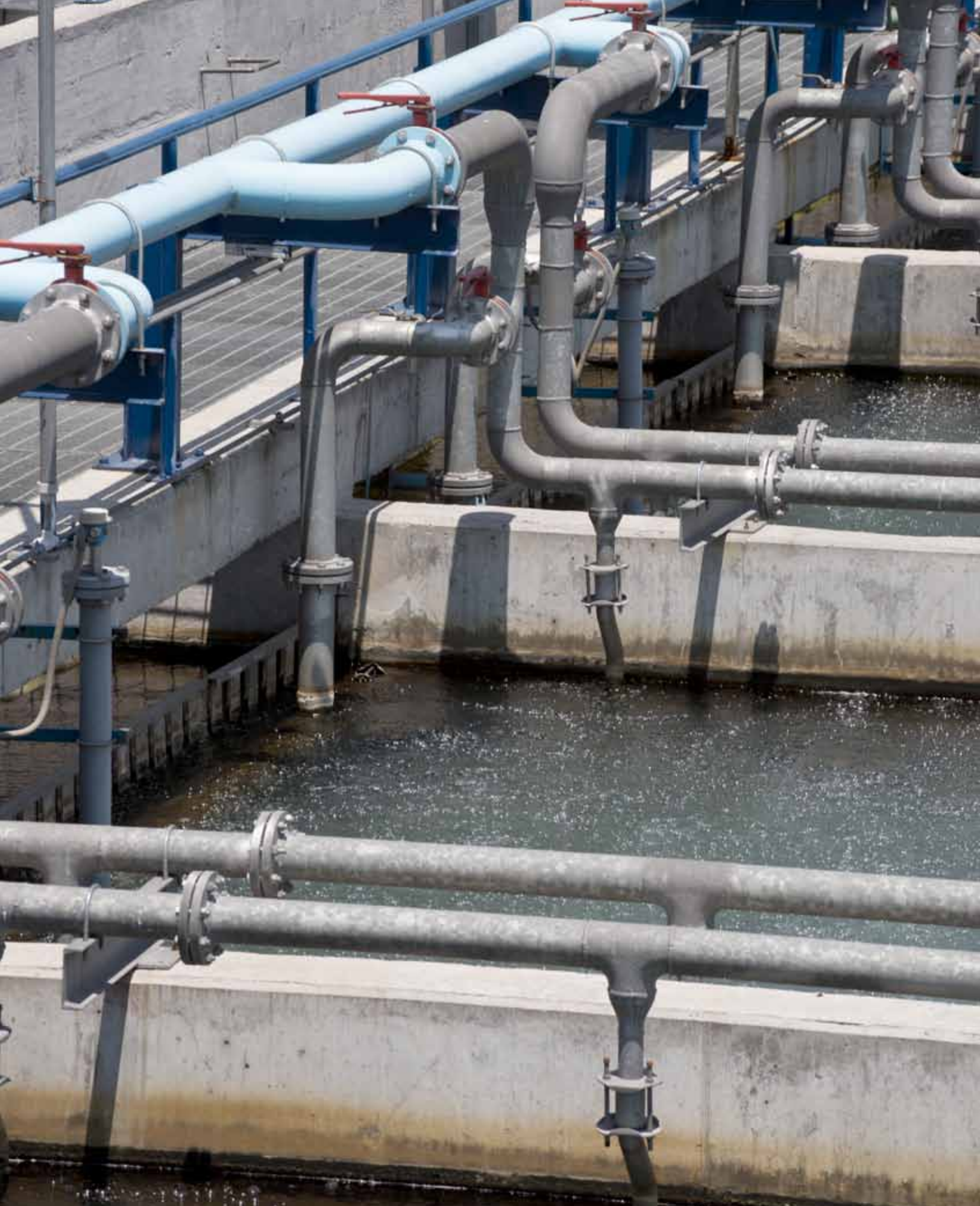
Piletas de agua residual en la planta de tratamiento Cerro de la Estrella.
