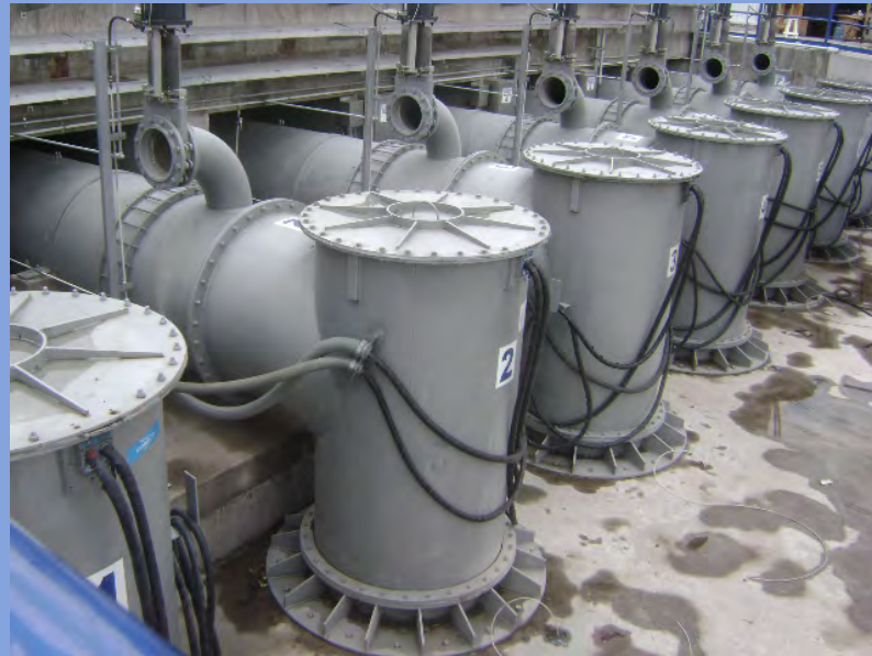
Planta de bombeo 11+600
