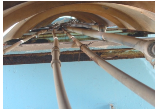
b) Tuberías de alimentación del coagulante.
