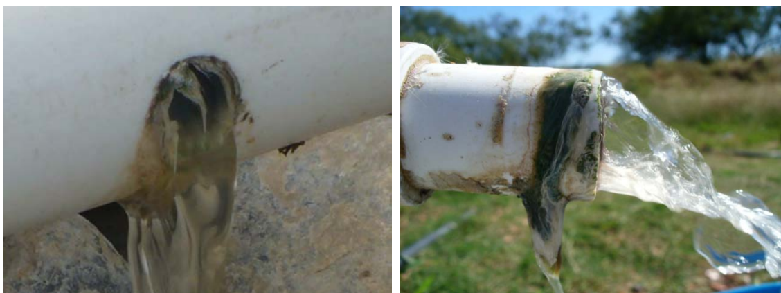
Figura 18. Acumulación de biocapa en estructuras de entrada de agua al pantano.
