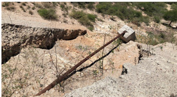
Figura 2. Falla en la cortina de la obra principal en El Portugués (El Portugués, Querétaro, 2018).
