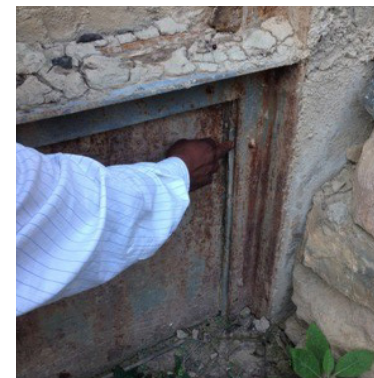
Figura 3. Falla en la compuerta desarenadora de la obra principal en El Lindero. (El Lindero, Querétaro, 2018).
