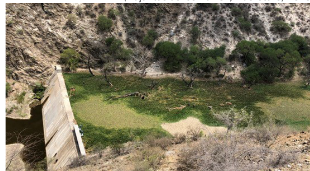
Figura 4. Azolvamiento de la obra principal en Adjuntas de los Guillén (Adjuntas de los Guillén, Querétaro, 2018).
