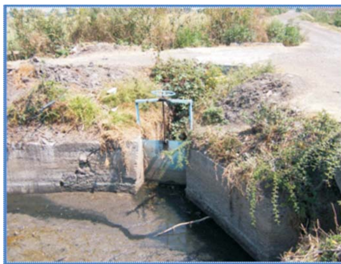
Estado de canales, azolve y deterioro.
