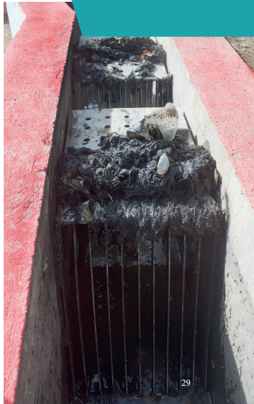
Figura 8.3. Detalle de las rejillas
