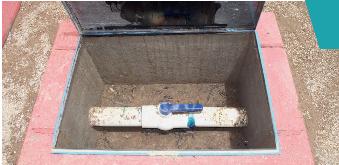
Figura 8.8. Válvula de salida del sedimentador
