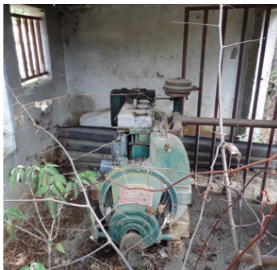
Figura N° 3. Caseta para bombeo y bomba de diésel Fuente: Valdez-Samaniego, (2018).
