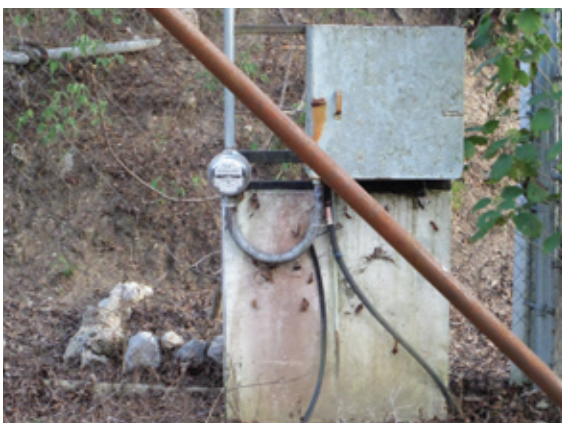
Figura N° 4. Caseta para bombeo e instalación de bomba eléctrica Fuente: Valdez-Samaniego, (2018).
