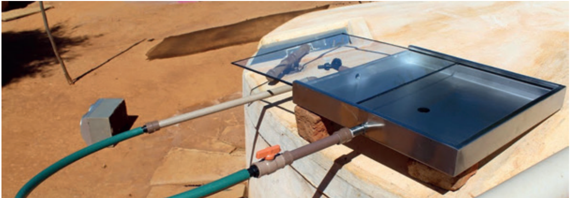
Figura Nº 4. Versão 10 do Aqualuz instalada na parte superior de uma cisterna
