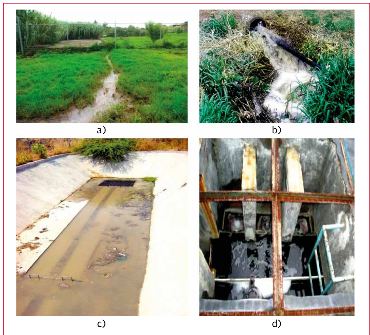
Ilustración A.5 Tendencia de los lechos a secarse. a) Taponamiento o roturas del colector, antes de llegar al sistema, b) Ordeña del agua de los lechos, c) Azolve del pretratamiento, d) Corrosión de estructuras de distribución de caudal
