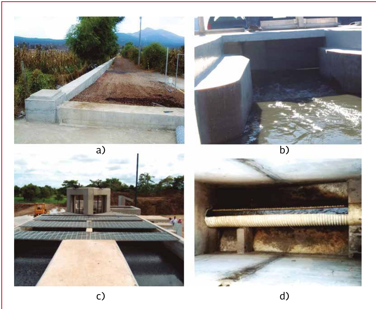
Ilustración 2.6 Tuberías de llegada y control de caudal en la entrada del humedal: a) Colector encofrado, b) Caja de llegada, c) válvula de control, d) tubería en mediacaña
