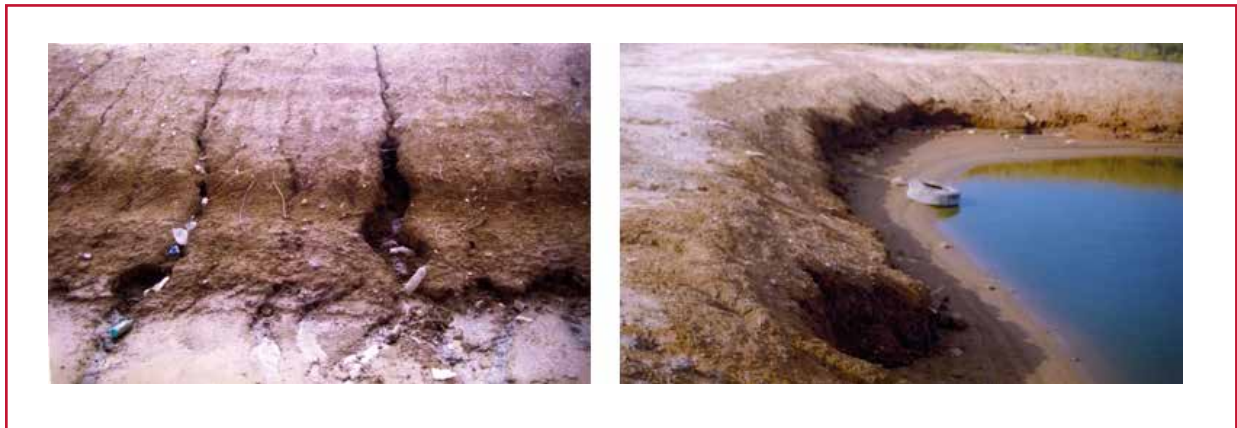
Ilustración 2.10 Bordos construidos con materiales inadecuados
