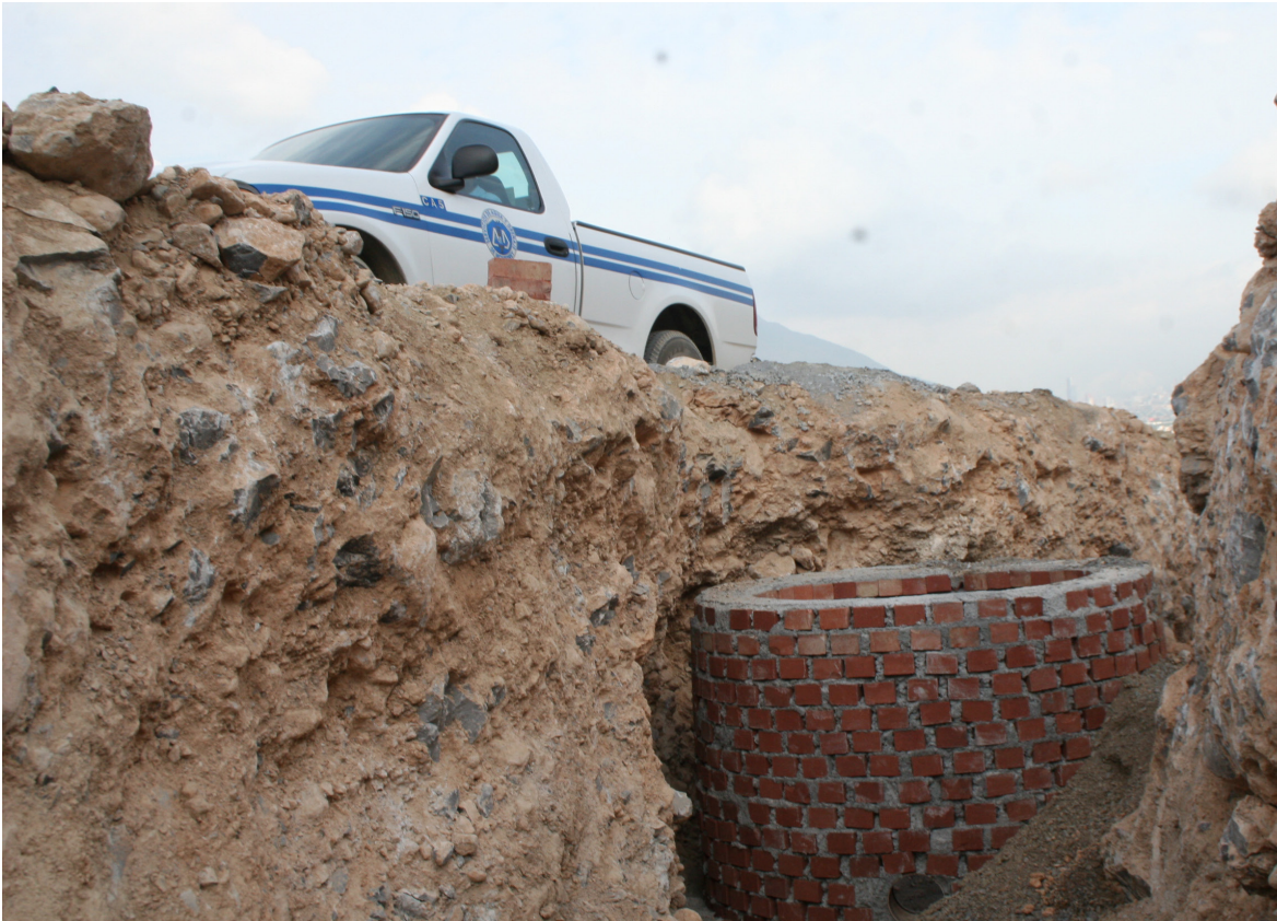
Infraestructura para drenaje sanitario. Fuente: Cortesía SADM.
