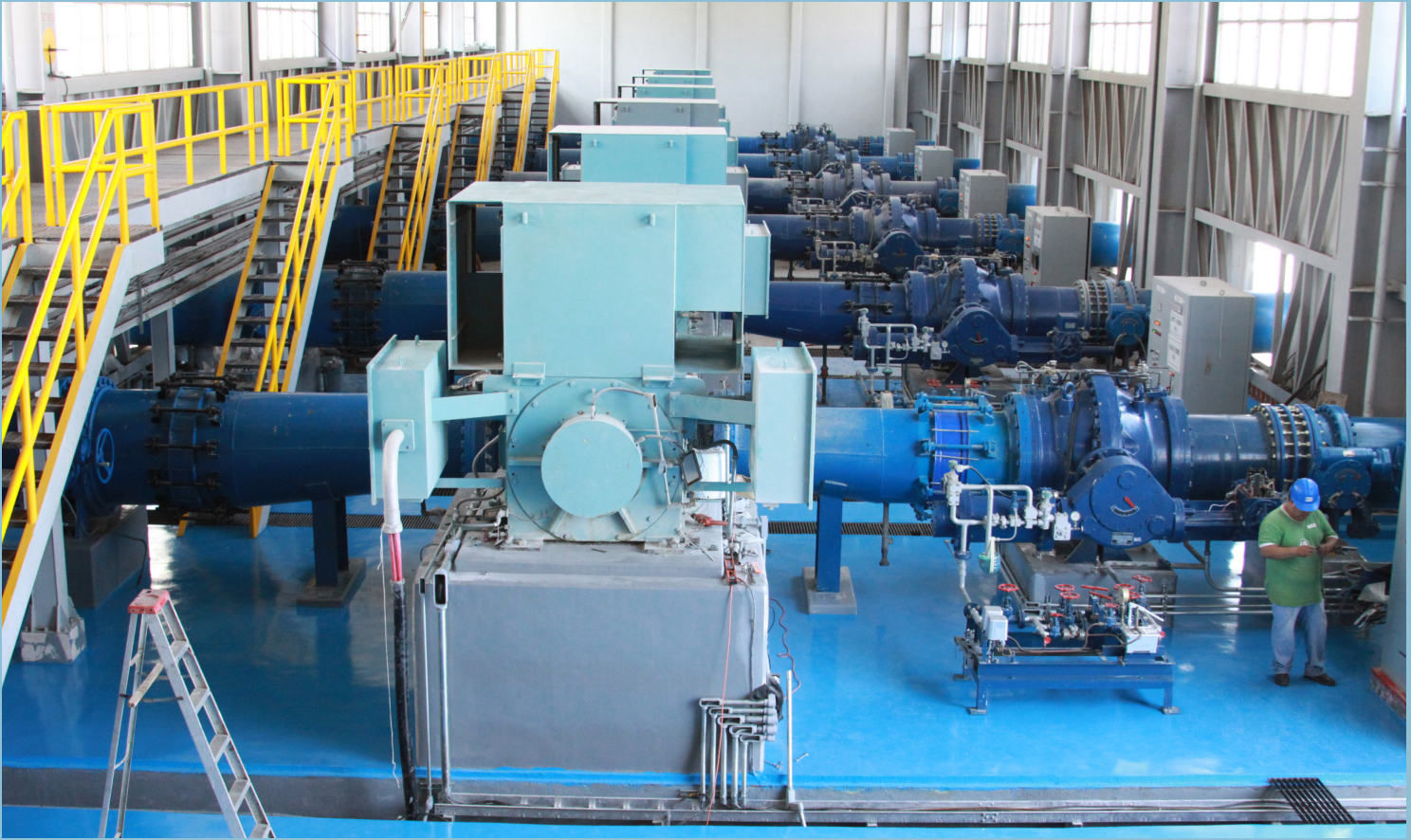
Planta de bombeo San Roque. Fuente: Cortesía SADM.
