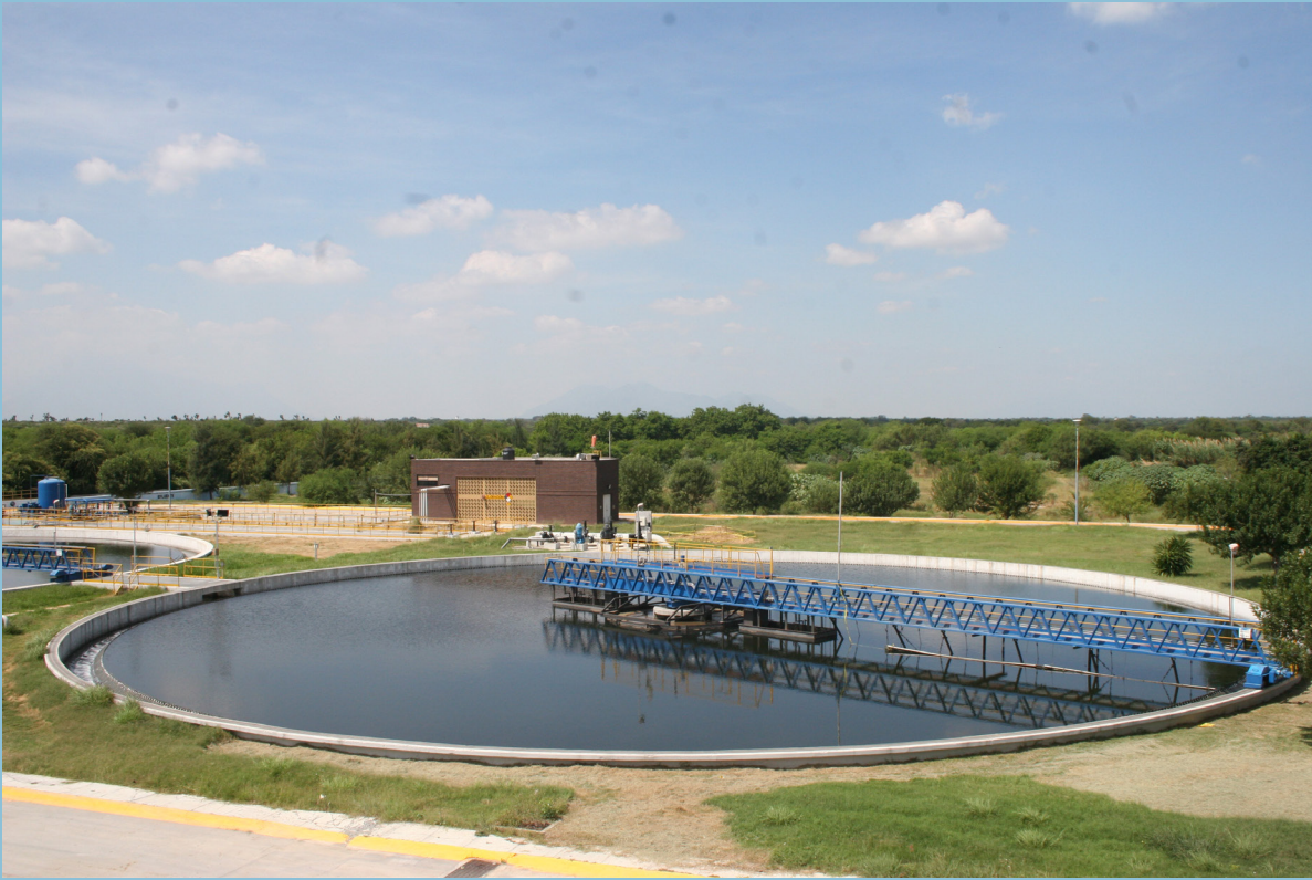
Planta de tratamiento. Fuente: Cortesía SADM.
