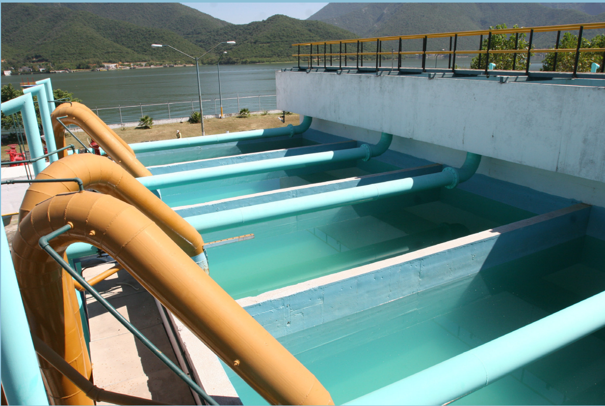
Planta potabilizadora. Fuente: Cortesía SADM.
