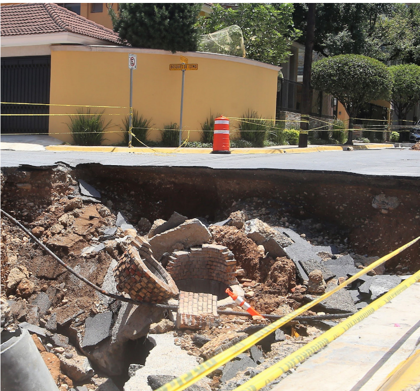
Daños tras la tormenta tropical Hanna. Socavón en San Pedro Garza García. Fuente: Fototeca Milenio [Raúl Palacios Rivera].
