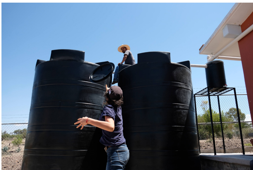
Sistema de captación de lluvia de 20,000 litros de capacidad en escuela primaria de Salitrillo. Julio, 2020.
