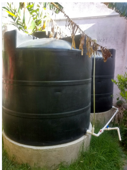
Modelo del Sistema de Captación de Lluvia instalado en las oficinas de Caminos de Agua con capacidad de 5,000 litros.
