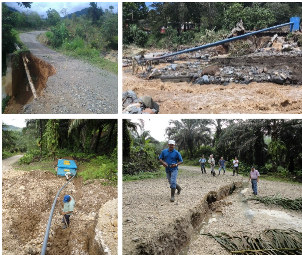
Figura 16. Afectación de redes de tubería en acueductos por deslizamientos, falla sísmica y escorrentía
