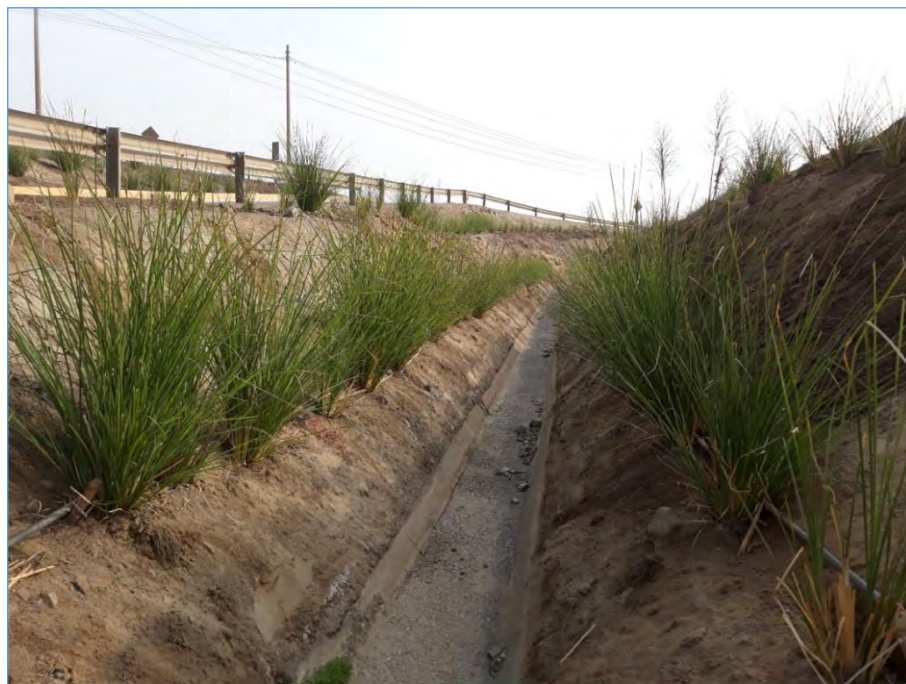
Figura 8-2. Estabilización de ladera con Vetiver ( Chrysopogon zizanioides L. Roberty) para la protección de infraestructura hidráulica en la región Costa
