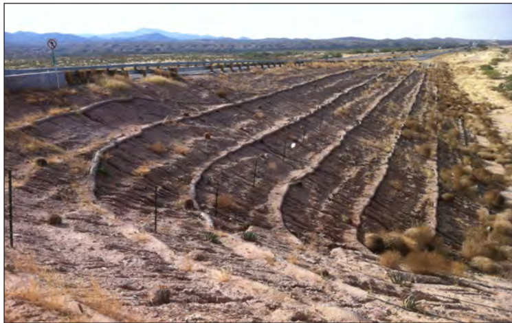
Figura 6-2. Típico ejemplo de un inadecuado control de la erosión y los sedimentos en zonas áridas de Estados Unidos, en donde por norma se aplican técnicas que son efectivas solamente en climas más húmedos
