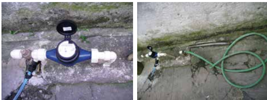
FIGURA 3 Hidrómetros y mangueras conectadas
