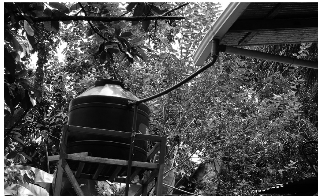
Figura 4. SCALL instalado en las parcelas Vegas las Palmas de Sixaola. Fuente: Jose Quirós Vega, 2015
