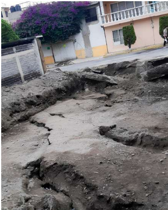
Figura 7. Agrietamiento descubierto cuando se construía un cajón de cimentación en la CDMX; apareció al retirar una capa de ~80 cm.
