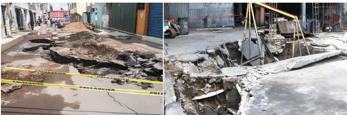
Figura 3. a) Colapso de túnel ocasionado por fuga en drenaje en CDMX; b) Colapso de túnel ocasionado por ondas sísmicas, 19/09/2017.
