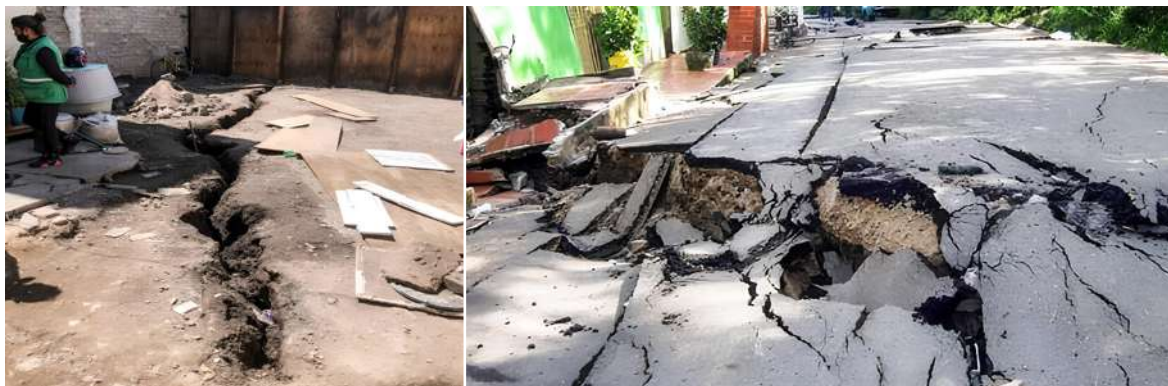
Figura 2. a) Grieta en la transición abrupta de la CDMX, aparición súbita durante la temporada de calor; b) Escalón en la CDMX formado durante el terremoto de 2017.
