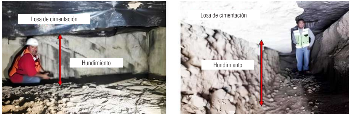
Figura 6. Espacio debajo del edificio creado por el hundimiento del suelo: la cimentación (losa-contratraves-pilas apoyadas en la Capa Dura) desconfina al no poder descender.
