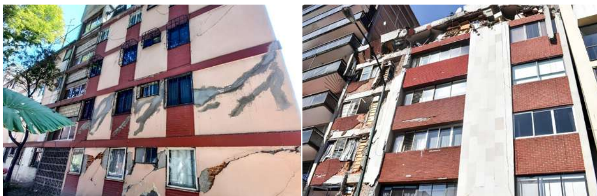
Figura 4. a) Edificio con pérdida de la vertical: asentamiento diferencial, deformación de los muros de carga; b) Edificio con pérdida de la vertical: pérdida de separación de colindancia, golpeo en el sismo.
