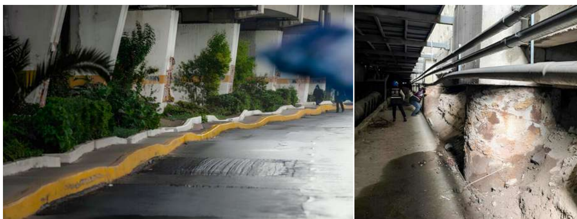
Figura 5. a) Puente con apoyos en la Capa Dura que no se desplazan; los materiales entre ellos se comprimen; reparaciones periódicas para mantener la operación de la avenida; b) Pilas de cimentación desconfiadas por la emersión aparente.
