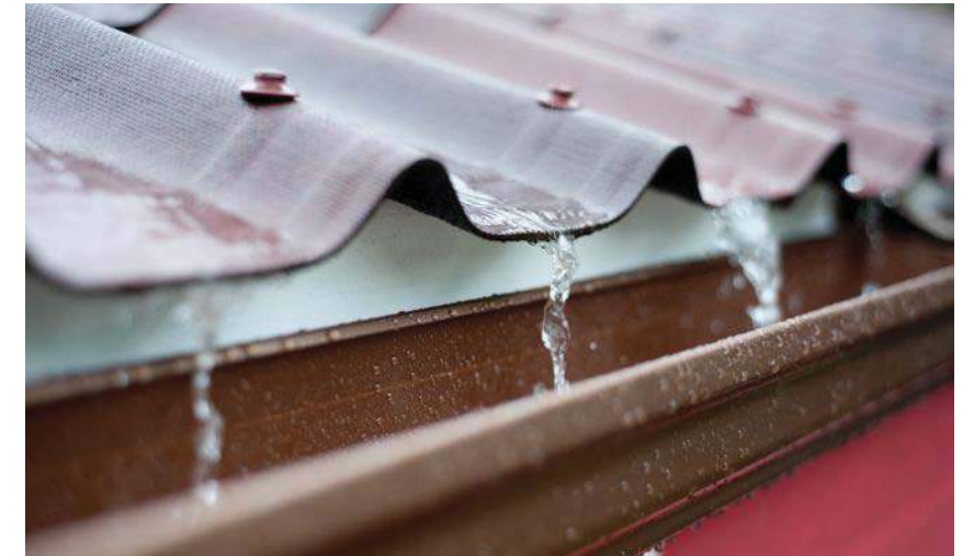
Figura 1.22 Captación pluvial. Ofrece una alternativa para la obtención del recurso vital, haciendo frente a la escasez del agua. Fuente: Disponible en: < http://www.esfacilserverde.com > Acceso en julio, 2015.
