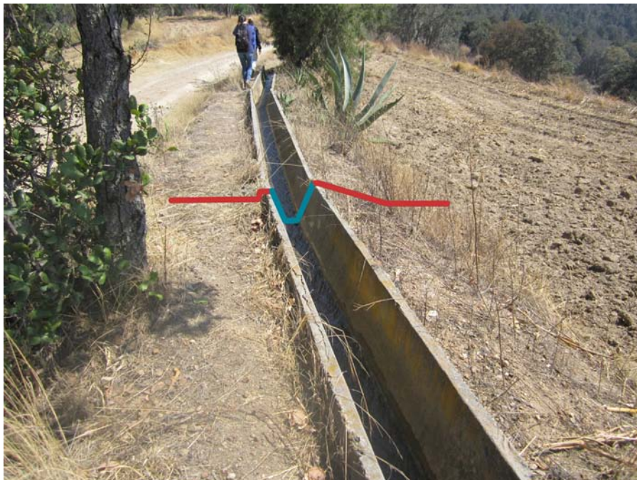
Figura 22. Canal en roca no consolidada recubierto con concreto sobre terreno plano. Fotografía y edición Laura Valera Pérez.
