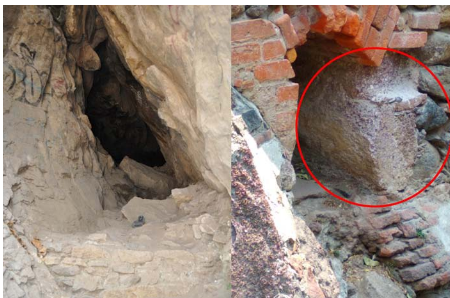
Figura 13. Cueva con escalón estucado, al noreste de la capilla del Señor de la Presa (izquierda). Restos de estuco en sistema de canales (derecha). Fotografía de Gustavo Coronel Sánchez, Molino de Flores Texcoco, Estado de México.
