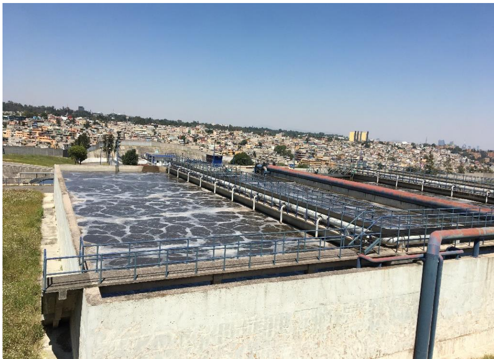
Figura 2.3.1 Planta de tratamiento de aguas residuales municipales Santa Fe en la Alcaldía Álvaro Obregón, Ciudad de México perteneciente al Sistema de Aguas de la Ciudad de México (SACMEX) en la Ciudad de México-2021 cuya agua tratada se comercializa para el riego de jardines y descarga de sanitarios en oficinas. Fuente: Fotografía de los autores.
