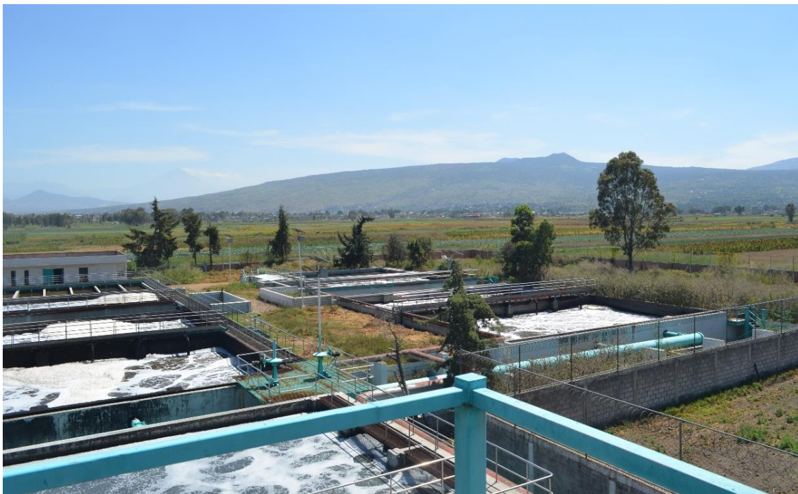
Figura 2.5.1 Planta de tratamiento de aguas residuales El Llano en la Alcaldía Tláhuac, Ciudad de México perteneciente al Sistema de Aguas de la Ciudad de México (SACMEX) cuya agua tratada se destina al riego agrícola. Fuente: Fotografía tomada por los autores.
