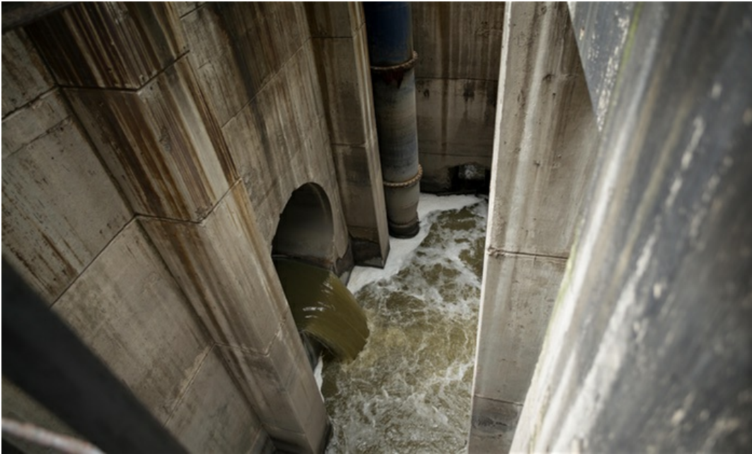
Estación de bombeo de aguas negras Sacmex, en la Ciudad de México. Photograph: Sean Smith for the Guardian
